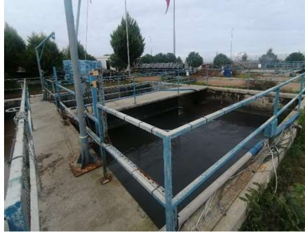
Fotoğraf 13. Havalandırma Tankı
