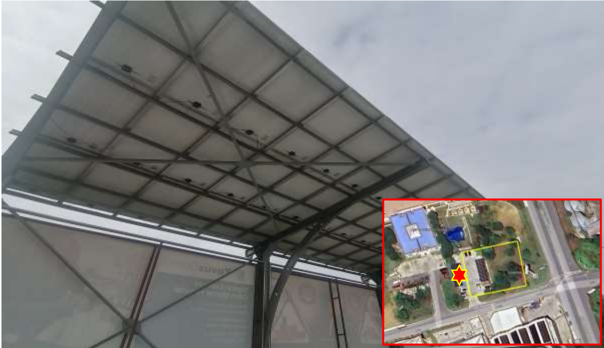
Fotoğraf 5. Mevcut Güneş Panellerinden Görünüm
