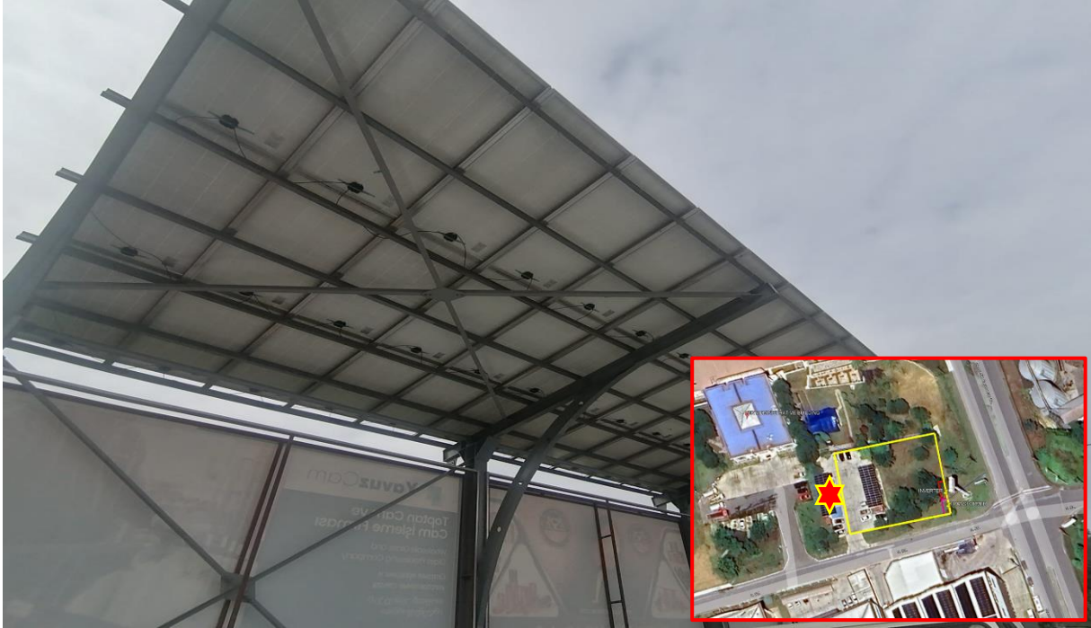
Fotoğraf 5. Mevcut Güneş Panellerinden Görünüm
