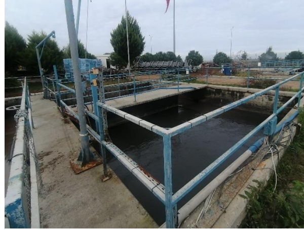
Fotoğraf 13. Havalandırma Tankı
