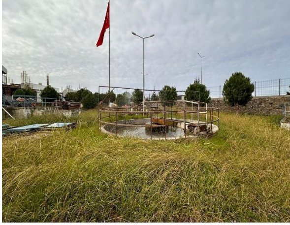
Fotoğraf 14. Dairesel Çöktürme Havuzu
